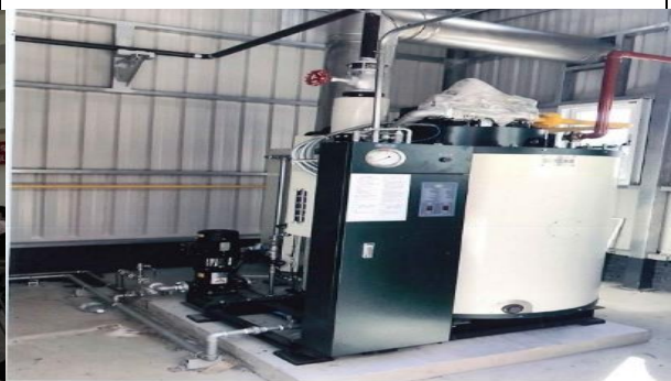
輔導業者改善高污染鍋爐 使用低污染性氣體燃料鍋爐
