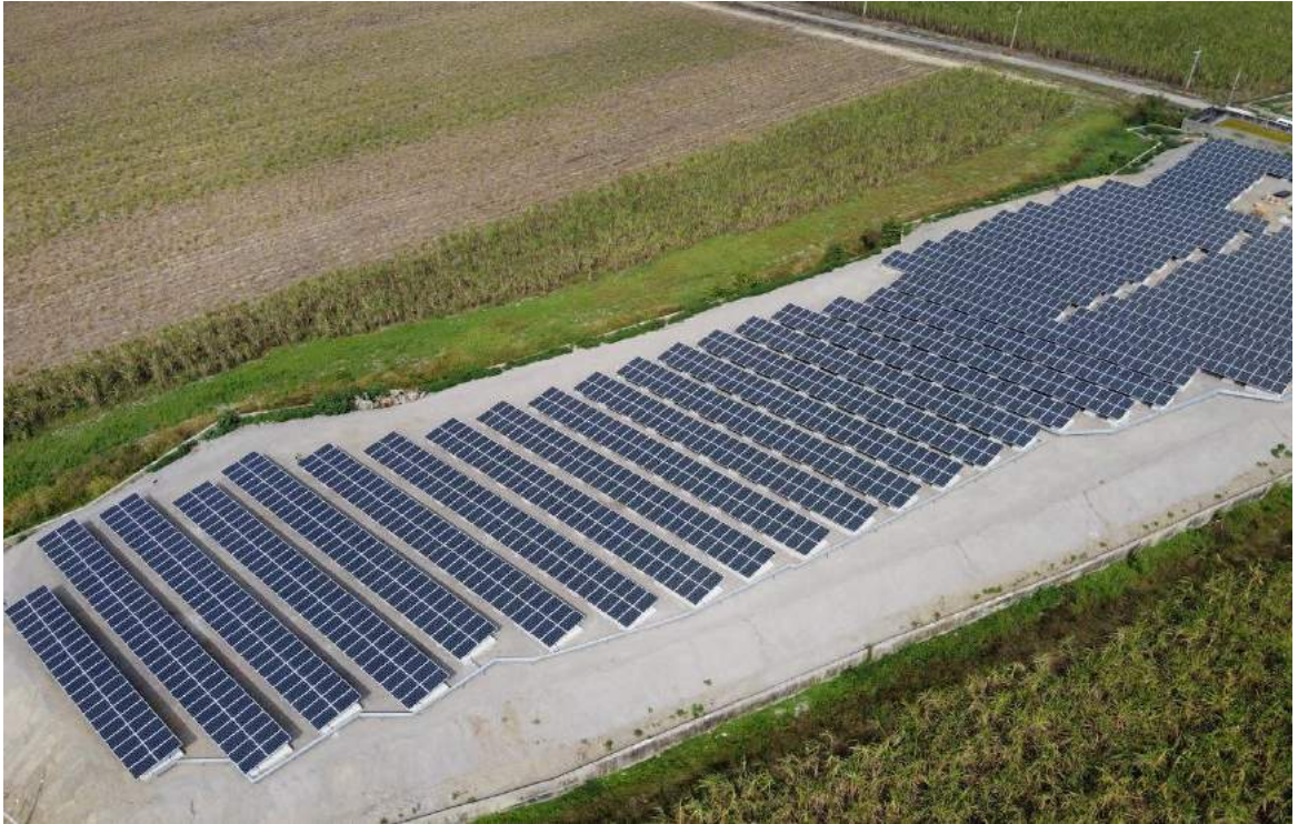
圖 2-2、臺南市後壁菁寮掩埋場種電
