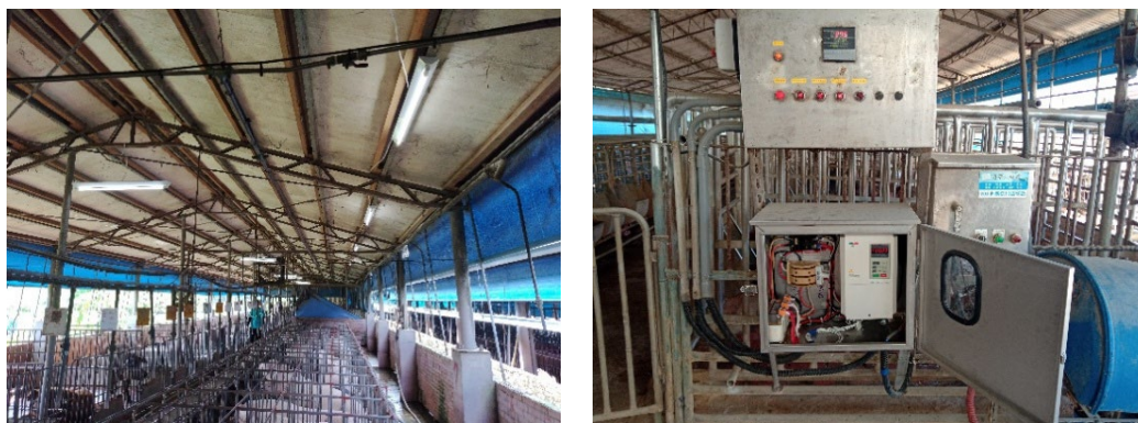
圖 26、省電燈具更換及風扇系統加裝變頻器
