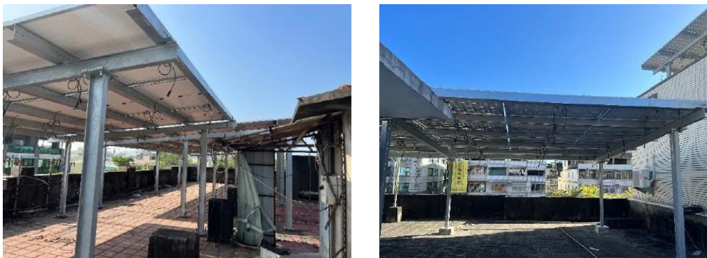
圖 11 派出所設置光電系統
