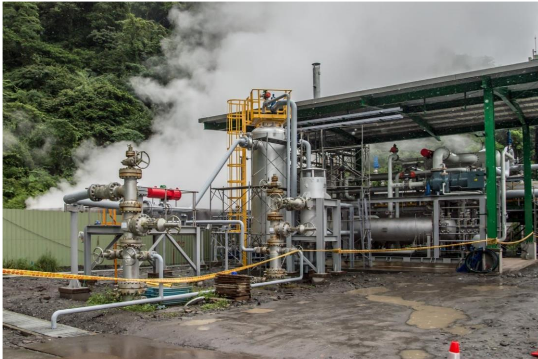
圖 2-3 仁澤地熱電廠朗肯雙循環發電機組
