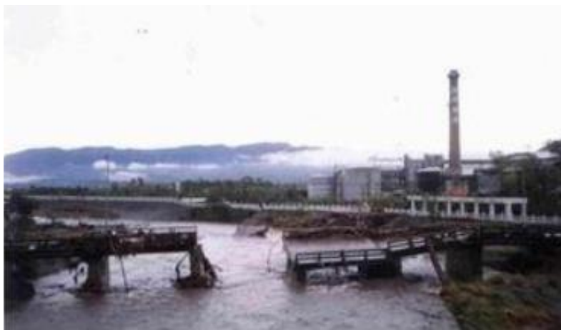
圖 4 社區橋墩受土石流衝擊毀斷
