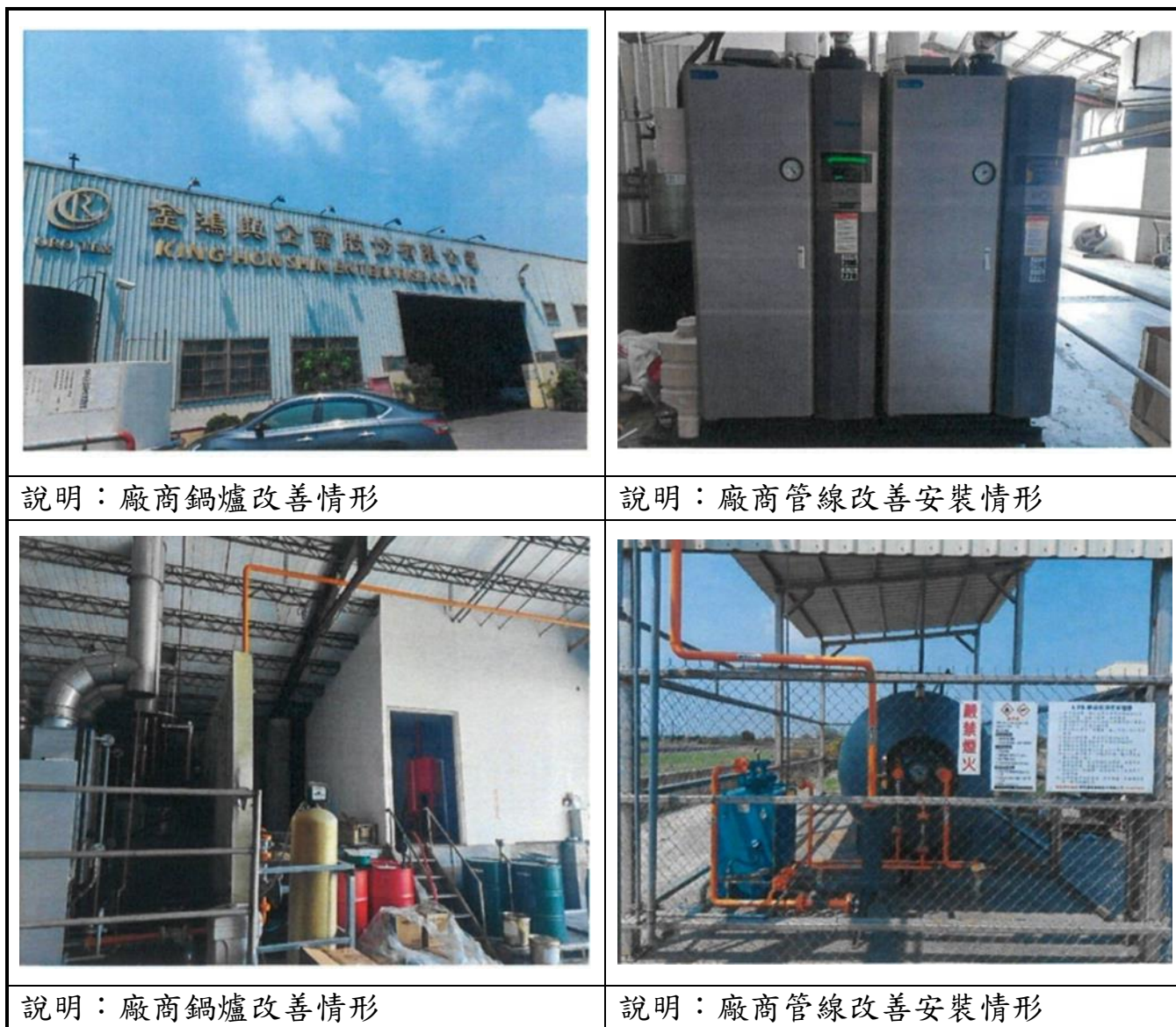
圖 3.2-1 工業鍋爐改善補助計畫執行情形
