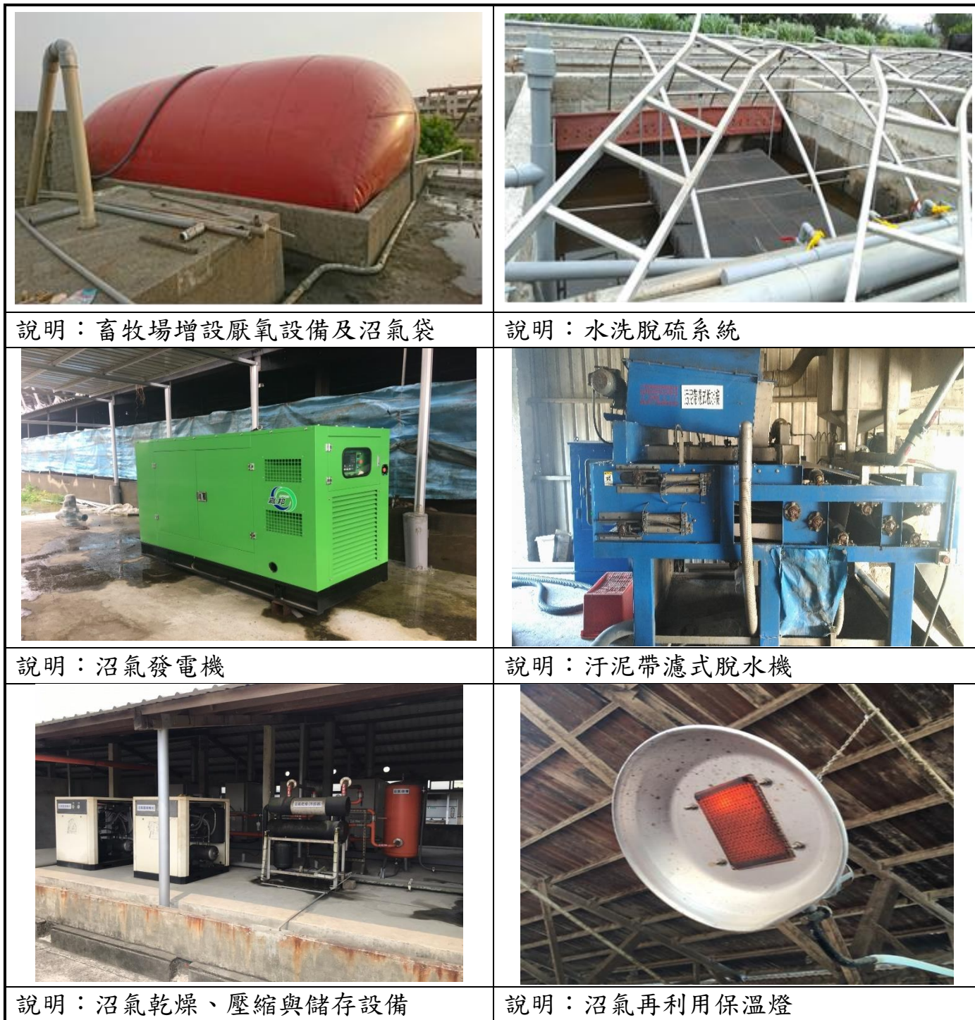
圖 3.1-4 養豬產業發電設備設置情形
