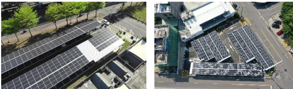
圖 6 公有停車場設置光電系統
