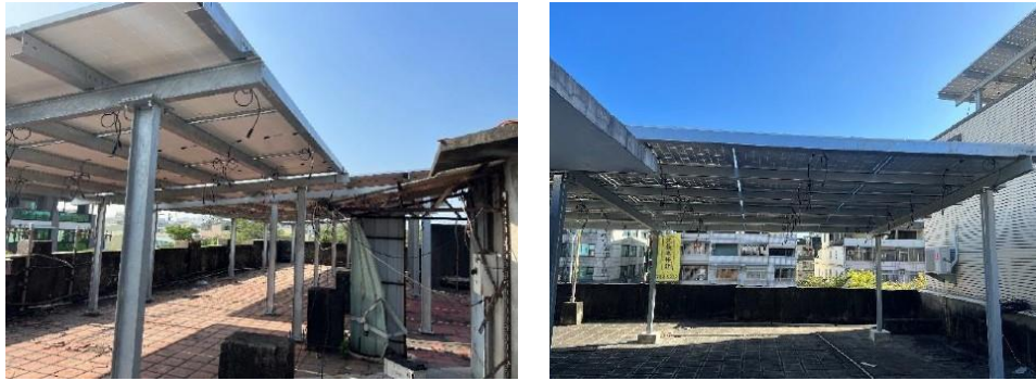
圖 7 派出所設置光電系統
