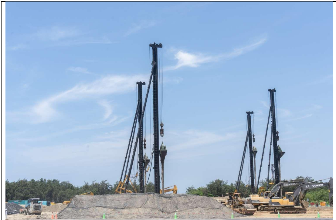
圖4_新竹海水淡化廠工程
