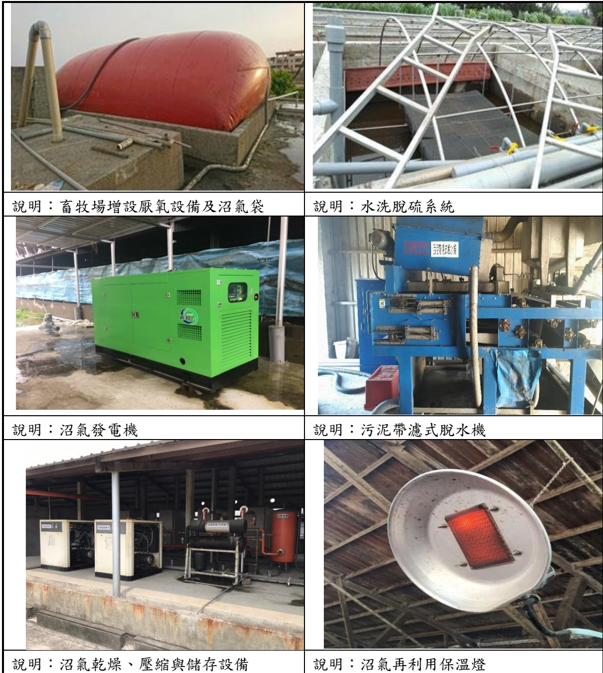
圖2-8 養豬產業發電設備設置情形
