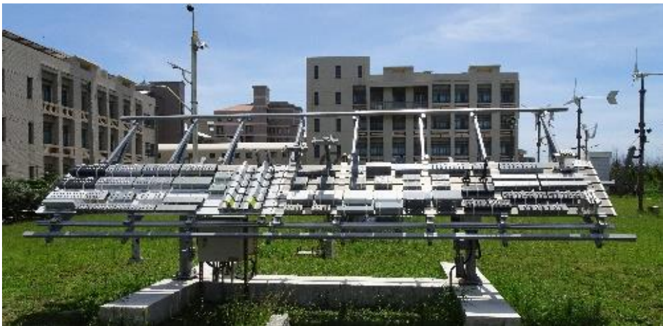
太陽光電支撐架老化試驗與管理
