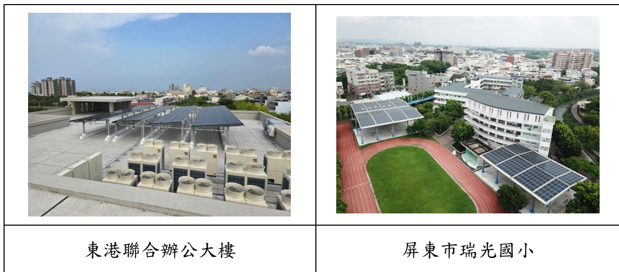
圖 2.1-4、校園及公務機關屋頂型太陽光電
