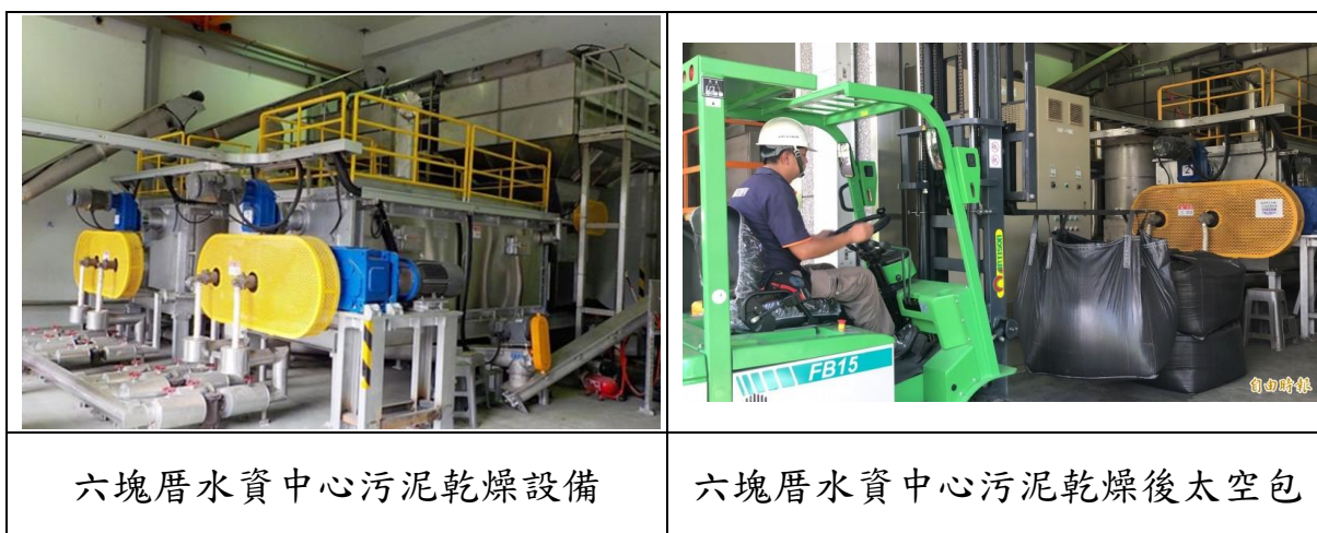
圖 2.6-13、六塊厝水資中心污泥乾燥設備
