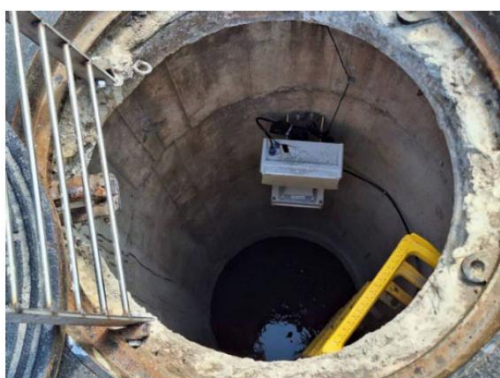
圖5 超音波水位即時監測器
