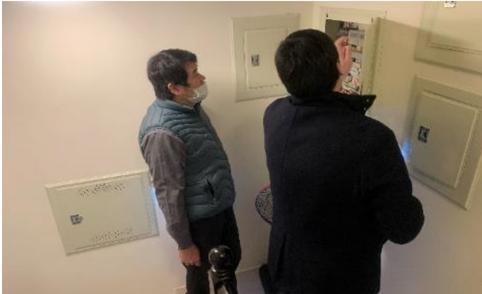
圖 17 公寓大廈節能輔導-電力控制調整
