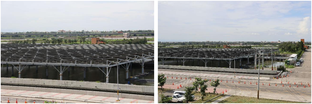
圖 3 台西水產試驗所漁電共生試驗場
