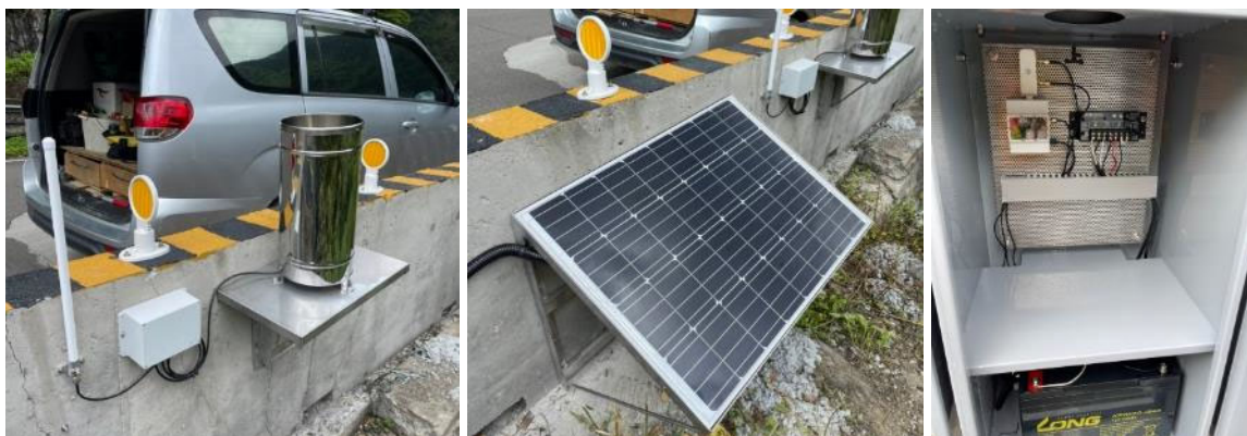
111 年度苗 21 線架設監測系統。(左)傾斜儀與雨量筒；(中)太陽能板；(右)監測主機。 圖片來源：交通工務處
