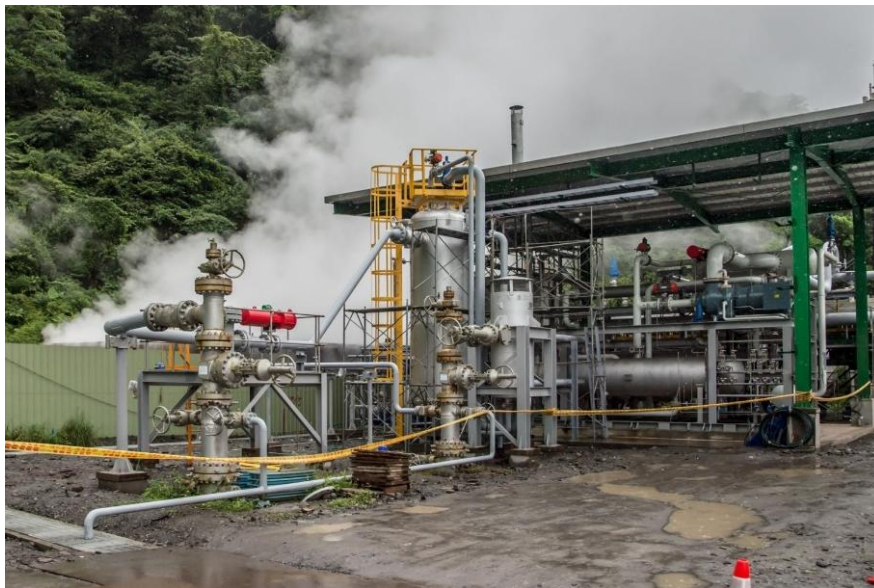
圖 2-3 仁澤地熱電廠朗肯雙循環發電機組
