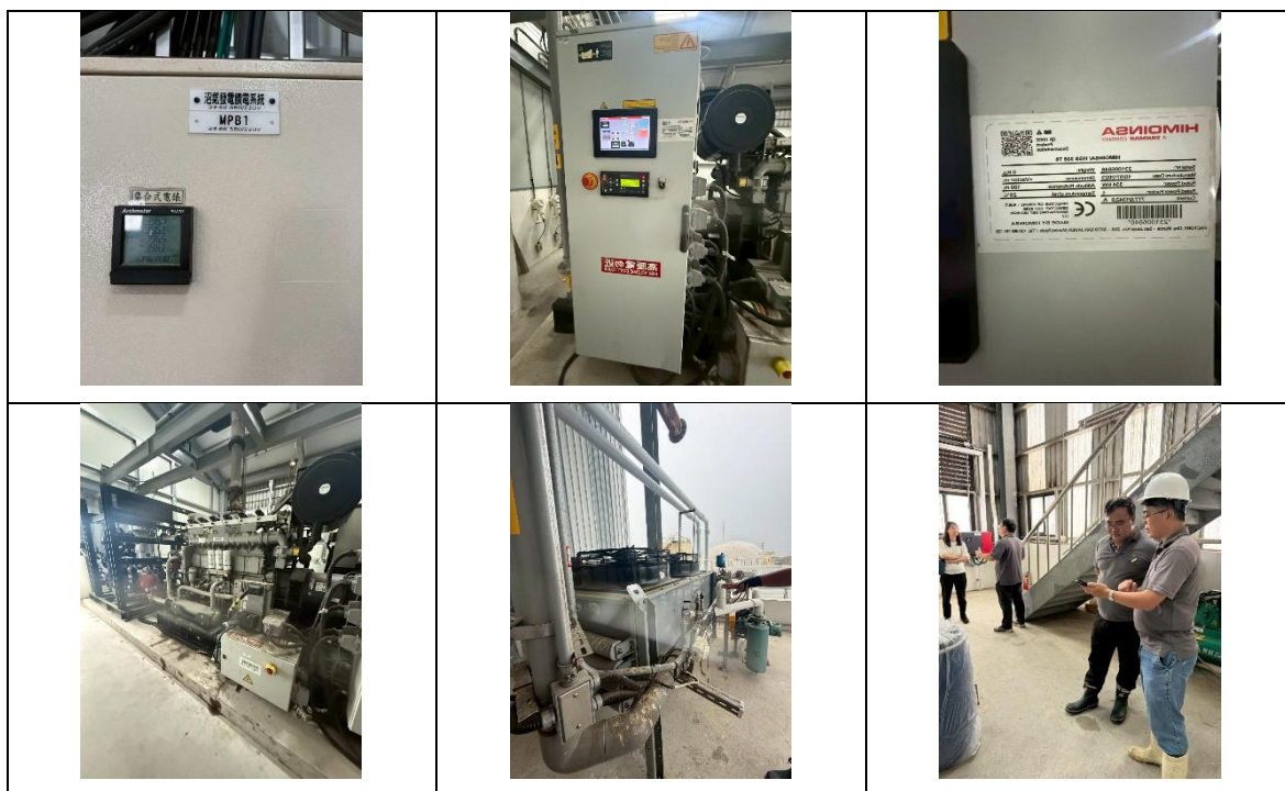
圖2.21 輔導畜牧場設置沼氣發電設備
