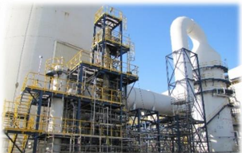
台塑/成大合作於高雄仁武廠汽電共生廠 CO 2 捕捉量約30噸/年，以鎳基觸媒轉換CO 2 成為甲烷，產量約10噸/年
