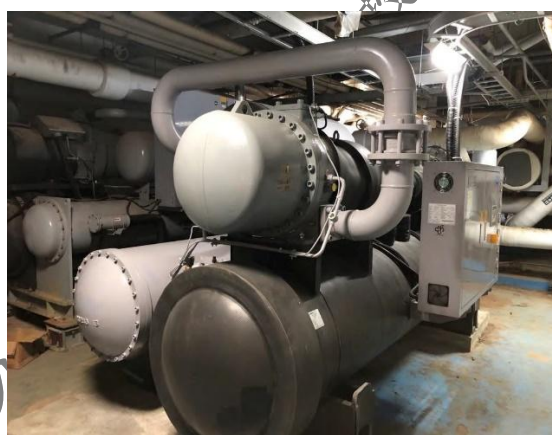
市立民生醫院冰水主機汰換
