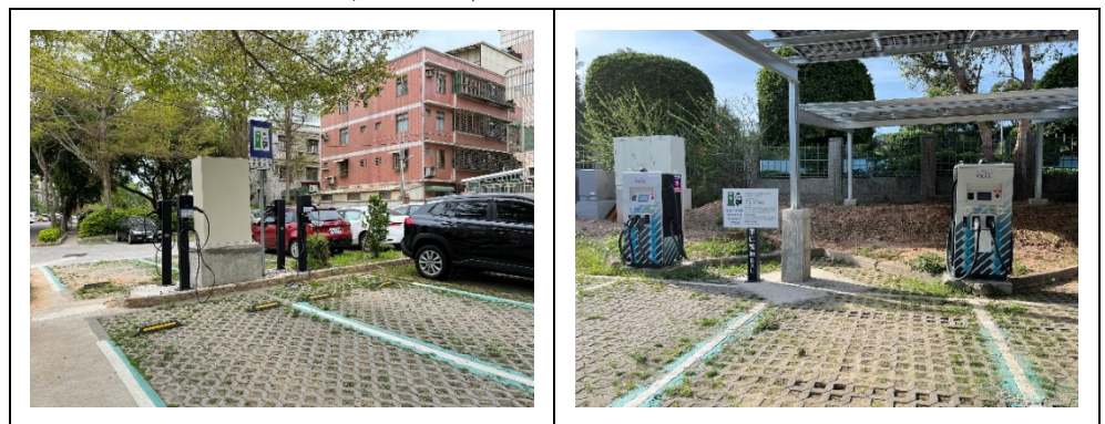
圖 2-5、公有停車場及公有場域電動車充電設施
