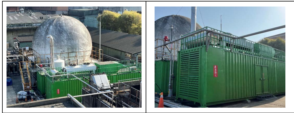
圖 2-2、金門酒廠沼氣發電設備
